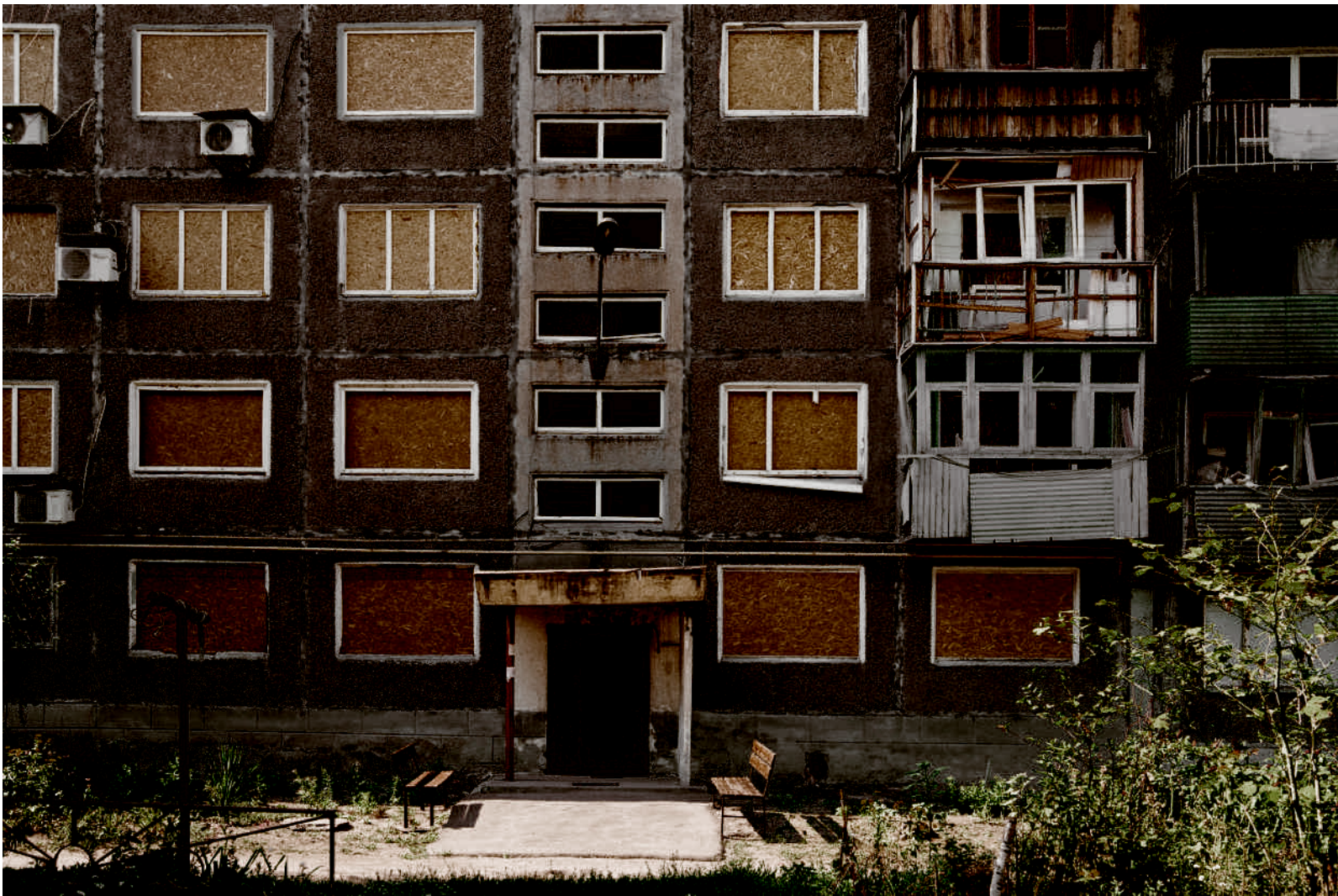
Lidé neopouští své domy i přesto, že jejich domov zasáhne bombardování. Po ostřelování se dřevotřískové desky běžně stávají náhradou za okenní tabule. Selydove, Doněcká oblast, červenec 2024
